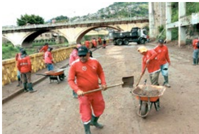
El operativo de limpieza de la Alcaldía Municipal, después que el río Choluteca bajó de nivel, realizaron trabajos de limpieza bajo el puente Carias en el paseo Marco Aurelio Soto.
