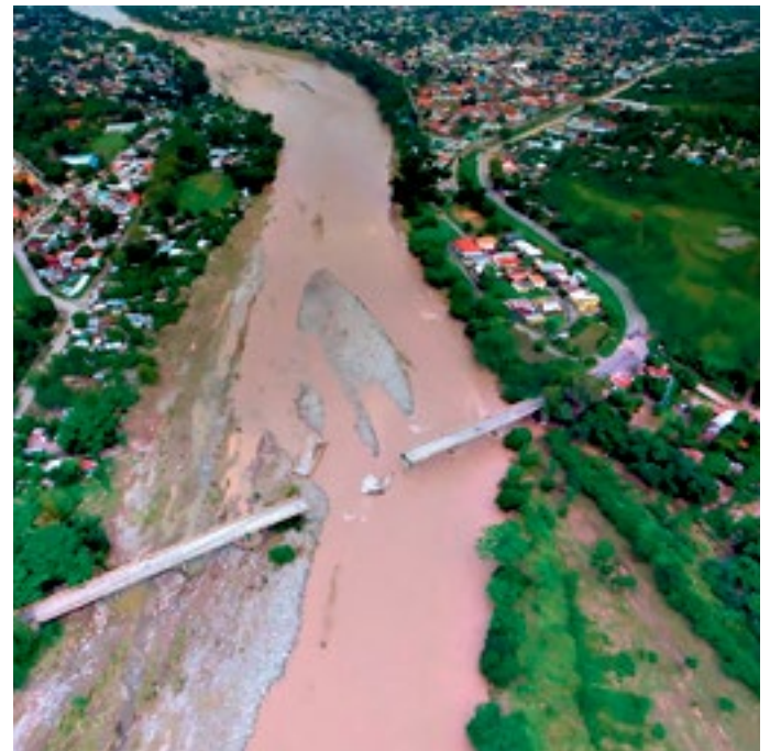
El principal puente de La Ceiba, Saopín colapsó dejando inco-municada a la población.
