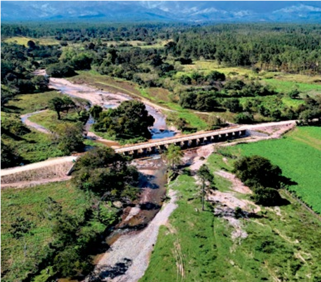
La construcción del puente en la aldea San Pedro de Pisijire, Dulce Nombre de Culmí, Olancho, está por finalizar con una inversión de más de 20 millones de lempiras.
