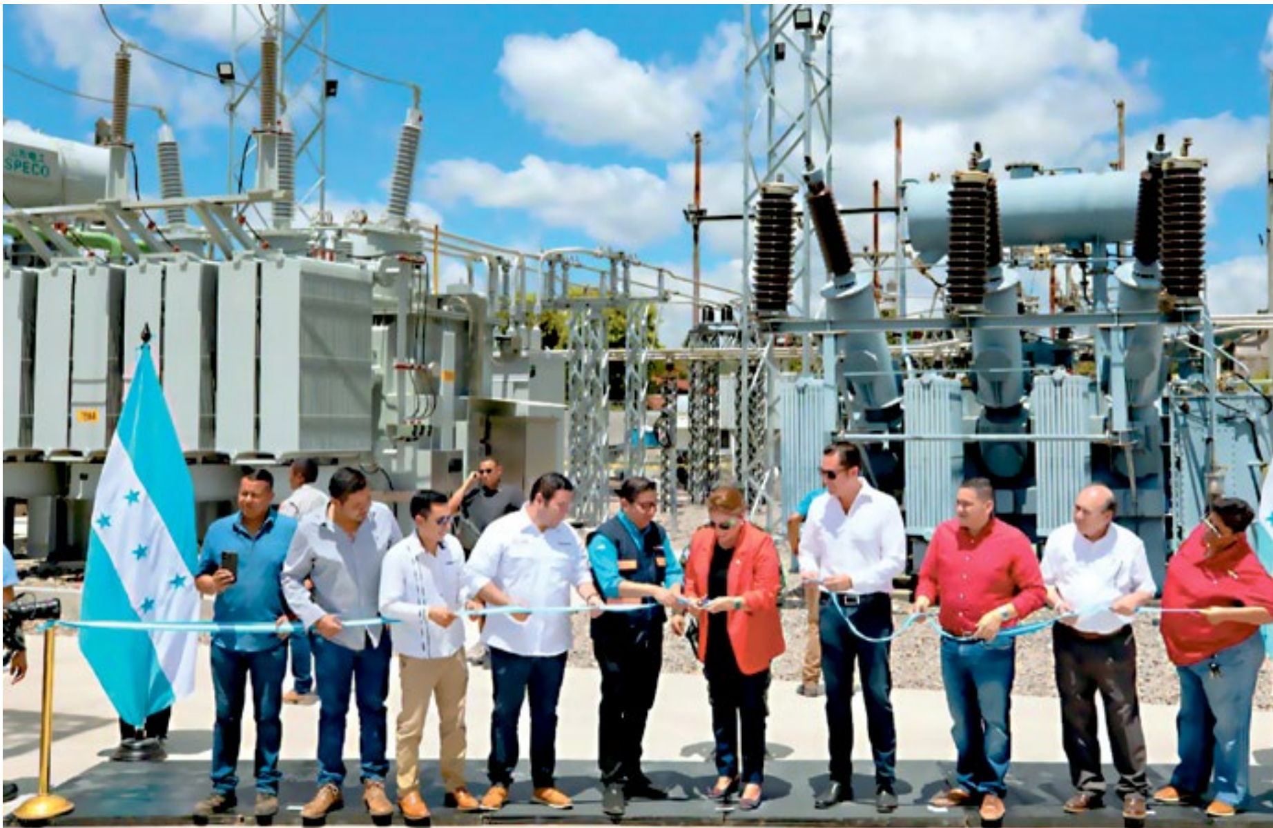
La Presidenta Xiomara Castro inauguró la décima subestación eléctrica, en Siguatepeque, acompañada por el Secretario Privado, Héctor Zelaya; el ministro de Energía, Erick Tejada; Christian Sanabria, gerente de Coordinación Técnica de la ENEE; la gobernadora de Comayagua, Ana Julia Flores; y el diputado Ronald Panchamé.
